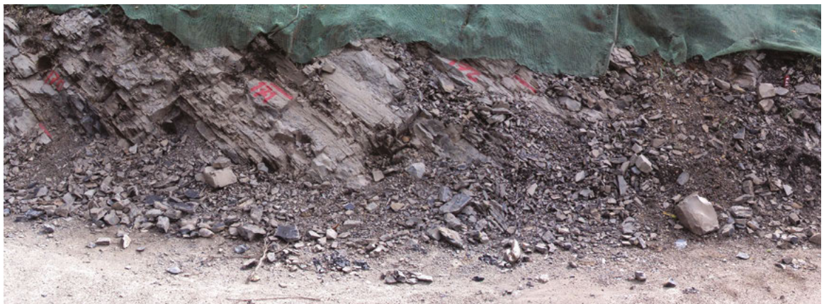
Figura 51. Parte inferior del segmento 10, wackestone de coloración gris parduzca, en capas delgadas, planas paralelas discontinuas, parcialmente cubierto con mallas sobre las cuales se siembra pasto para su estabilización geotécnica; Formación Galembó, m270,0-m274,0 (N:1.263.706, E:1.076.200, Z:446, Az:275°).
