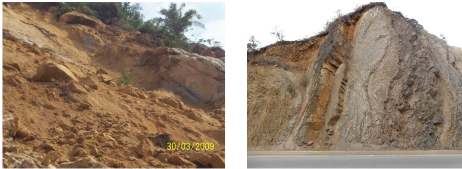
Fotografía 19. Deslizamiento planar (izq.), deslizamiento de cuña(der.). Ambos en estratos sedimentarios, cordillera Oriental.
