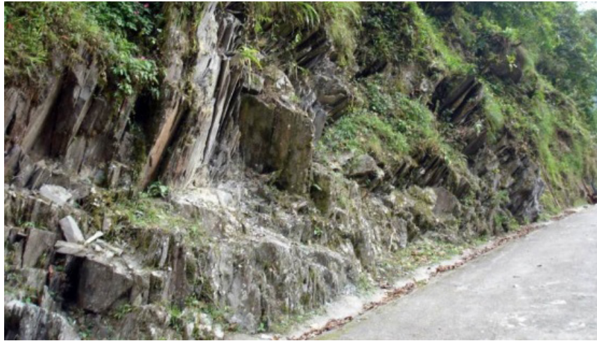
Fotografía 16. Volcamiento flexional en la margen izquierda de la quebrada Chirajara (Cundinamarca).
