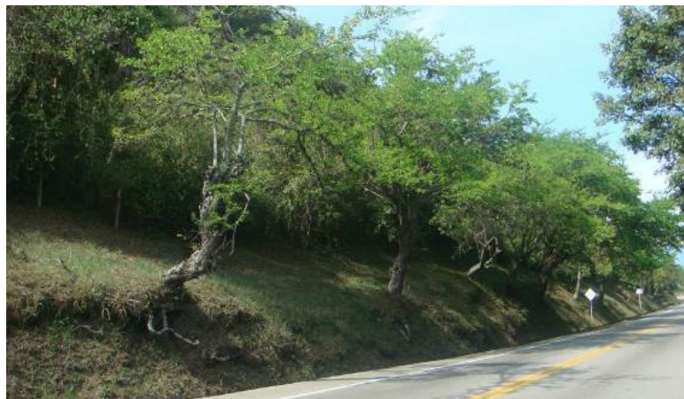
Fotografía 24. Creep superficial, vía sustitutiva presa Sogamoso.
