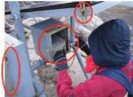
Figura 8. Corrosión de los elementos de algunas estaciones en las estructuras de soporte y seguridad para los elementos de medida (Mejía & Botero, 2008).
