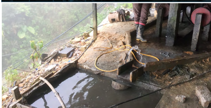
Fotografía 6.16. Tanque sedimentador. Fuente: autores.
