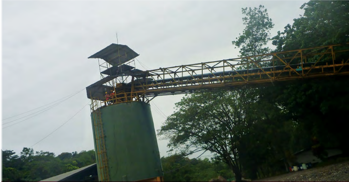
Fotografía 7.9. Tanque de proceso de la planta el Limón. Fuente: Autores.
