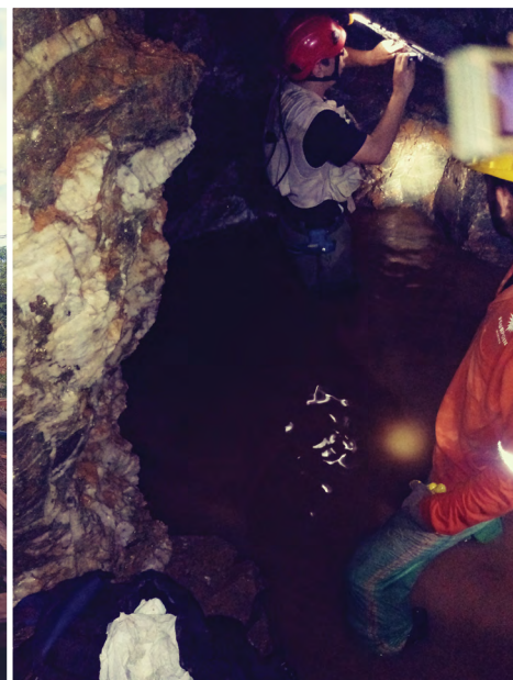
Fotografía 5.12. Trabajo con infiltración de agua. Fuente: autores.
