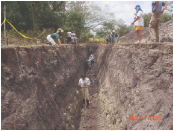
Figura 39. Instalación de los hilos verticales; se inició desde la parte más baja de la trinchera.
