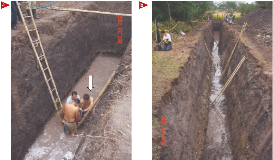
Figura 36. a. Acumulación de aguas lluvias en la parte más profunda. Note la pendiente que favorece el flujo de agua hacia el fondo de la trinchera. b. Extracción del agua con motobomba.
