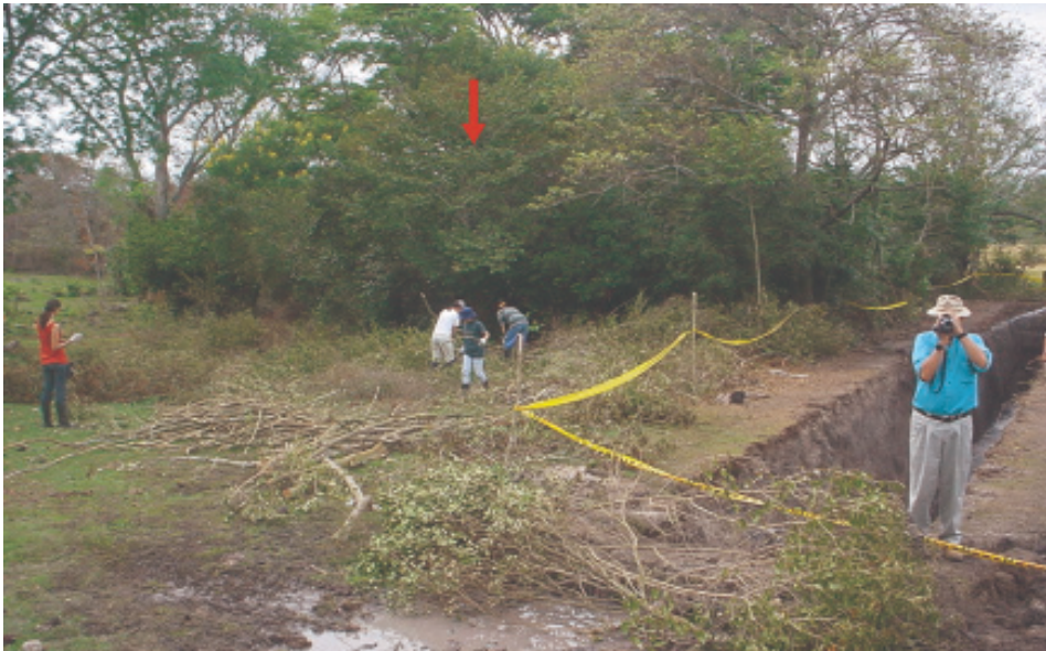
Figura 37. Trabajo de adecuación de troncos y palos generados en el descapote para cubrir el piso de la trinchera. Si se tiene guadua, es más fácil de colocar y permite un cómodo desplazamiento dentro de la trinchera.
