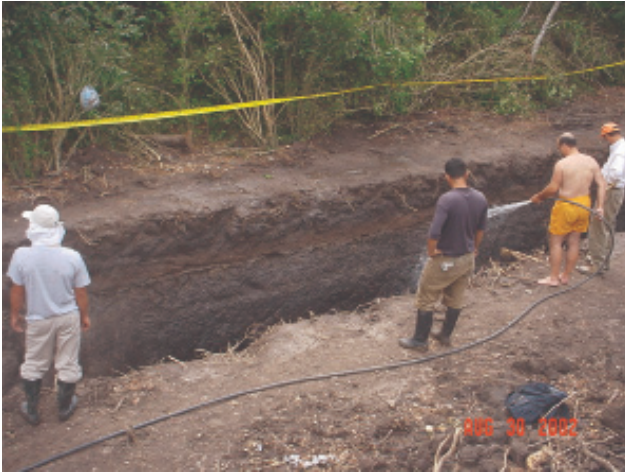
Figura 33. Lavado a chorro de las paredes de la trinchera y demarcación con cinta de seguridad.
