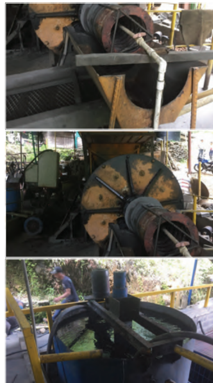
Fotografía 6.17. Molino de bolas, Tolva y molino, Precipitador, planta El Porvenir
